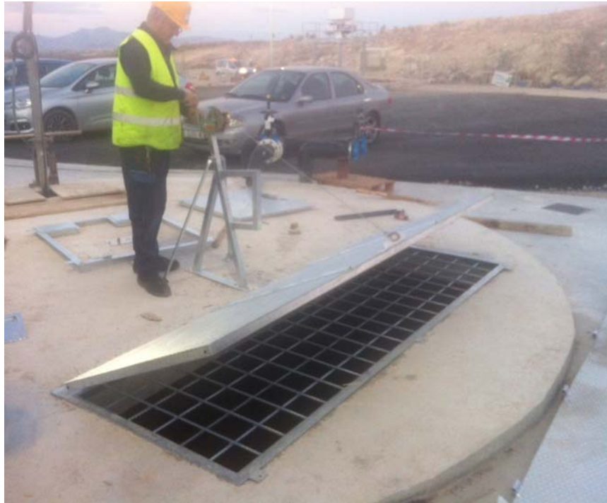
Imagen 13. Apertura de descarga del tanque de recepción de líquidos en planta de biogás agroindustrial situada en Los Alcázares (Murcia), proyecto diseñado y construido por el autor del documento
