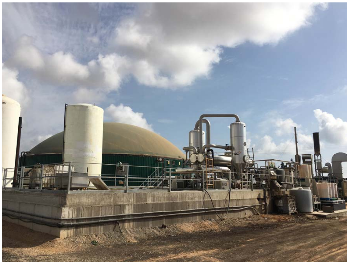
Imagen 20. Evaporador de digestatos de similares condiciones de operación al descrito en este documento, instalado en planta de biogás agroindustrial de Murcia
