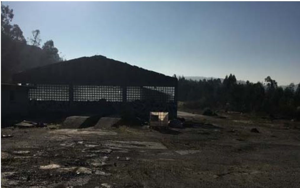
Imagen 25. Nave que será derruida para sobre su emplazamiento construir los digestores de la planta de biogás. Como puede comprobarse, el medio está fuertemente antropizado.
