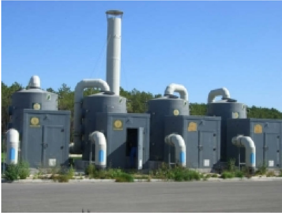
Imagen 12. Imagen de sistema de filtros de carbón activado
